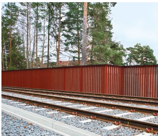
Støyskjermer ved Högberga Stasjon på Lidingöbanen i Stockholm.
